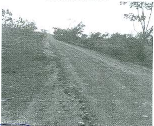
FOTO - PT 30- LH 16 SENTIDO 22 REF 1,2 KM A PARTIR DA LH 22 SENTIDO RO 473
