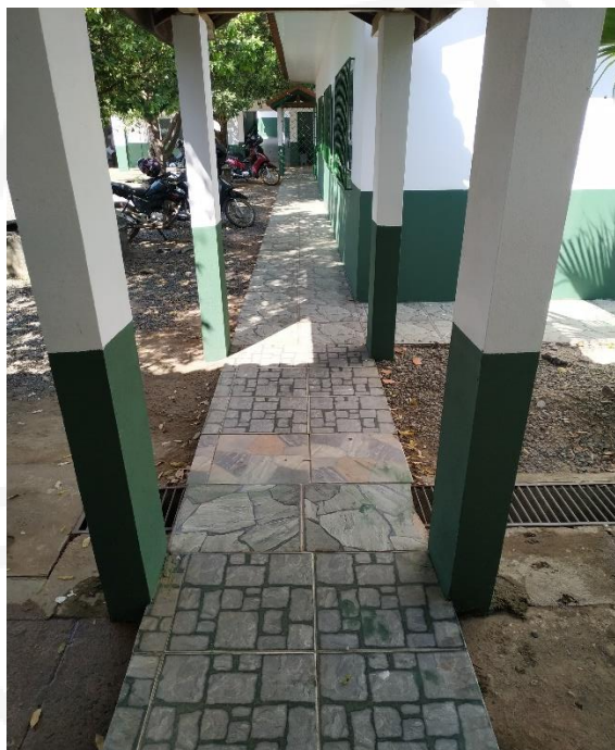
Figura 6: Corredor piso irregular
