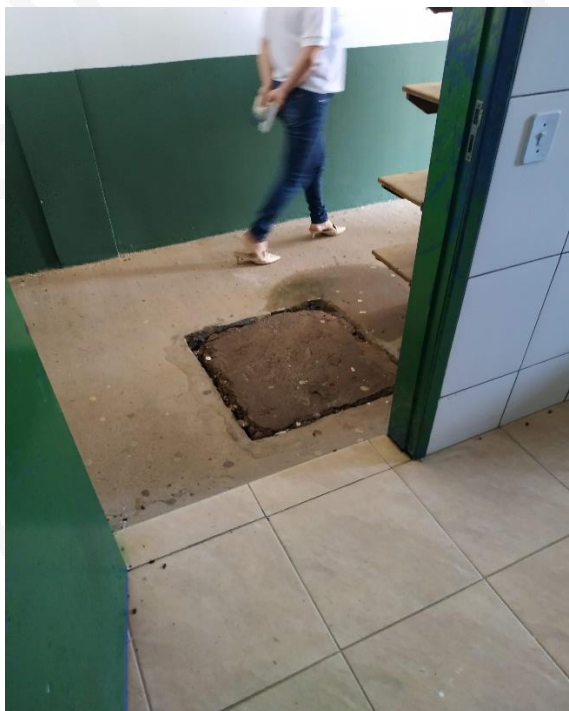
Figura 16: Irregularidades do piso
