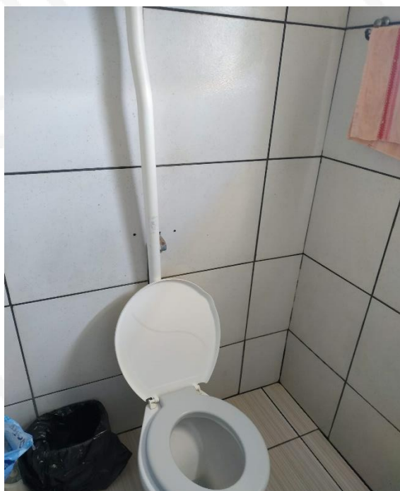
Figura 8: Sanitário sem acessibilidade
